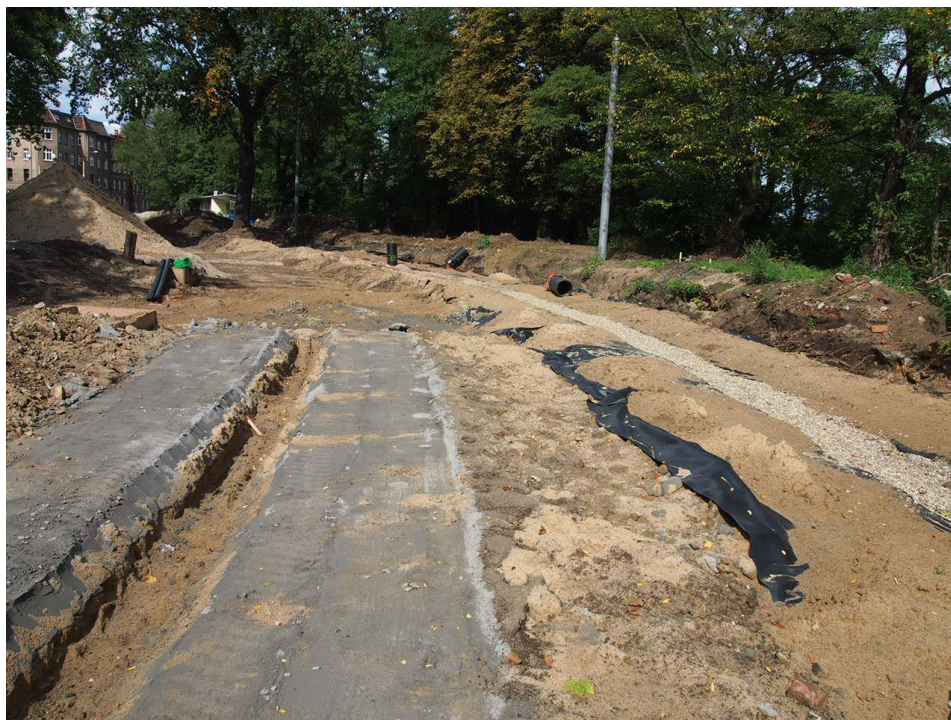
ul. Potulicka –teren pętli tramwajowej - wzmocnienie podłoża gruntowego w miejscu przebiegu torowiska
