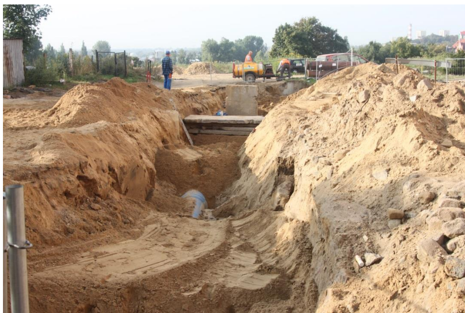
ul. Potulicka – magistrala wodociągowa
