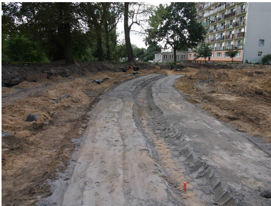
ul. Potulicka –teren pętli tramwajowej - wzmocnienie podłoża gruntowego w miejscu przebiegu torowiska
