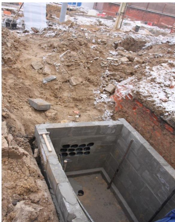
studnia teletechniczna ul. Potulicka
