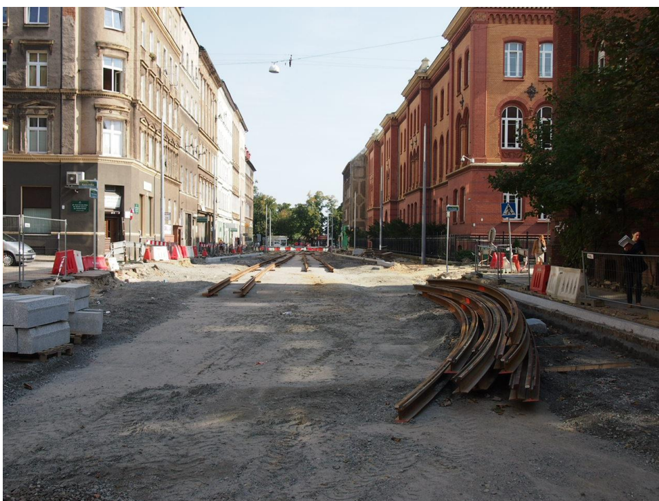
ul. Narutowicza – przygotowanie szyn do montażu na skrzyżowaniu ul. Narutowicza z ul. Potulicką
